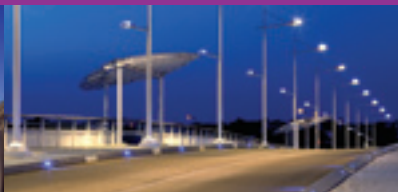
Les luminaires routiers
